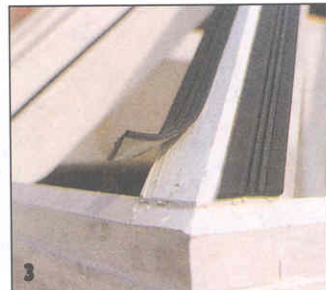
Сначала подготовили к остеклению стропила. На них на монтажной самоклеящейся ленте наклеили профилированные резиновые уплотнители.
